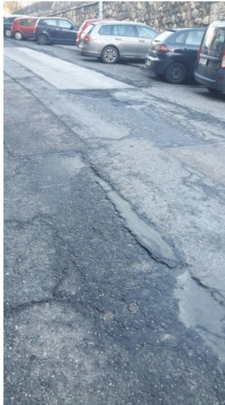
Rossz állapotú, felújítandó útburkolat
