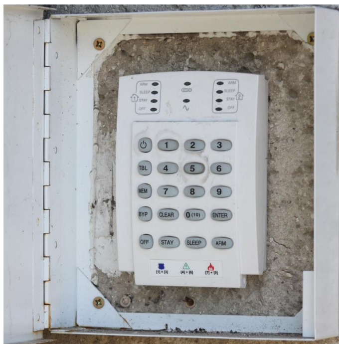
160. ábra Riasztórendszer vezérlő doboza
